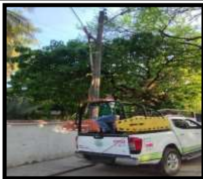
SE ATENDIÓ REPORTE DE ÁRBOL SOBRE UNOS CABLES EN LA CALLE MATAMOROS, COLONIA SAN MIGUEL.
