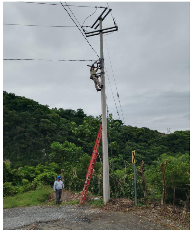
AXHUMOL ARREGLO DE LUMINARIAS
