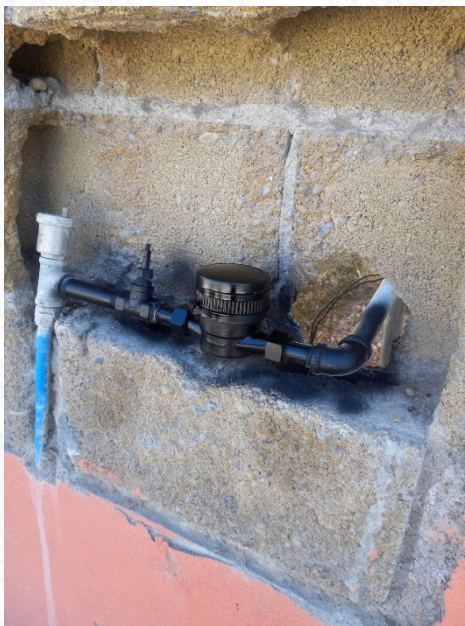
Imagen 11. Cuadro exterior con medidor
