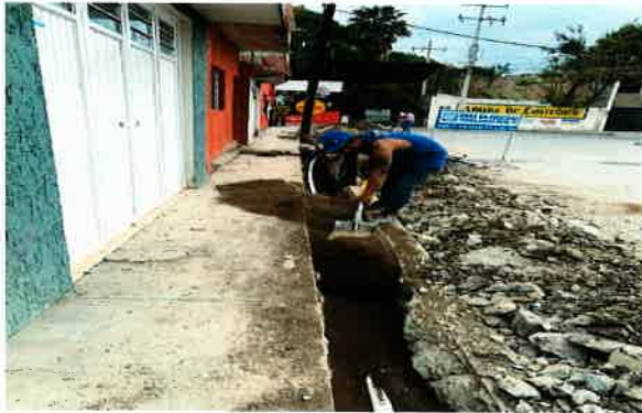
RELLENO EN ZANJAS COMPACTADO AL 85% PROCTOR, CON MATERIAL DE BANCO. (ACOSTILLADO DE ARENA).
