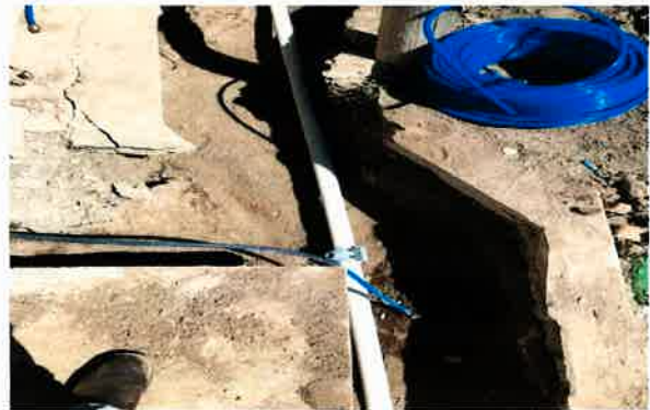
RECONEXION DE TOMA DOMICILIARIAS DE AGUA POTABLE EN 1/2" DE DIAMETRO, INCLUYE: TODO LO NECESARIO PARA SU CORRECTO FUNCIONAMIENTO.
