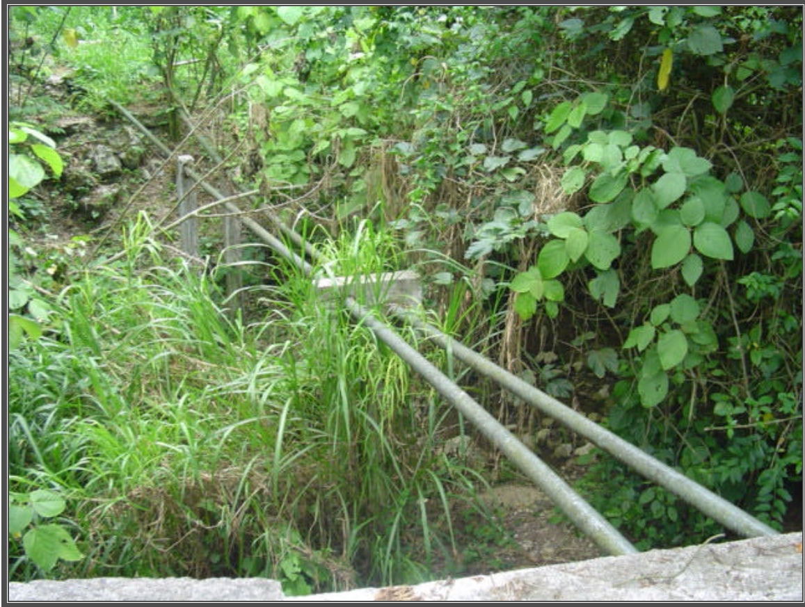
Fotografía No.38 Tubería de alimentación hidráulica
